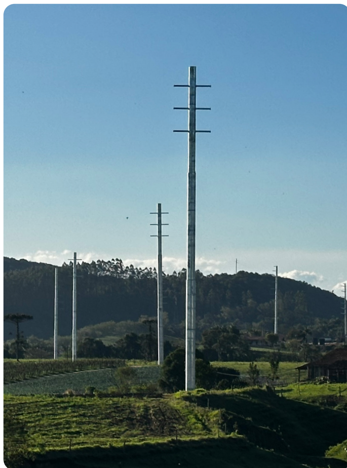
LD 138 kV Cegero e Cerbranorte - Tubarão Sul RB/SC
